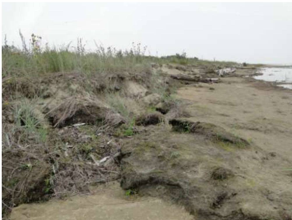
Рисунок 3.21 – Размыв берега со стороны Байкала в районе устья р. Кичера.
