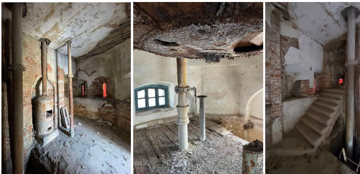
Рис. 8. Внутренний вид башни: печь (а), навесной бак для воды (б), лестница (в). 1893 г. (совр. состояние).
